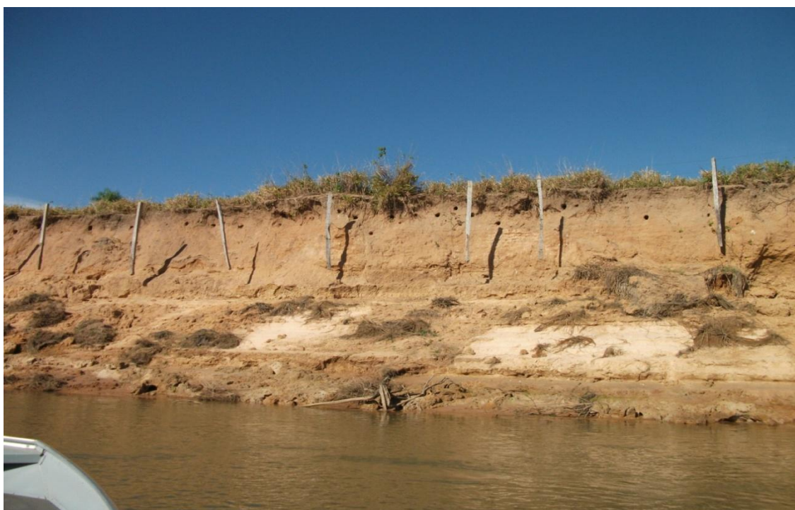
Figura 07 – Recuo do Barranco do Retiro Velho: área de ocupação das margens (pasto) com conseqüente recuo do barranco. (Fonte ESFS – 2010)
