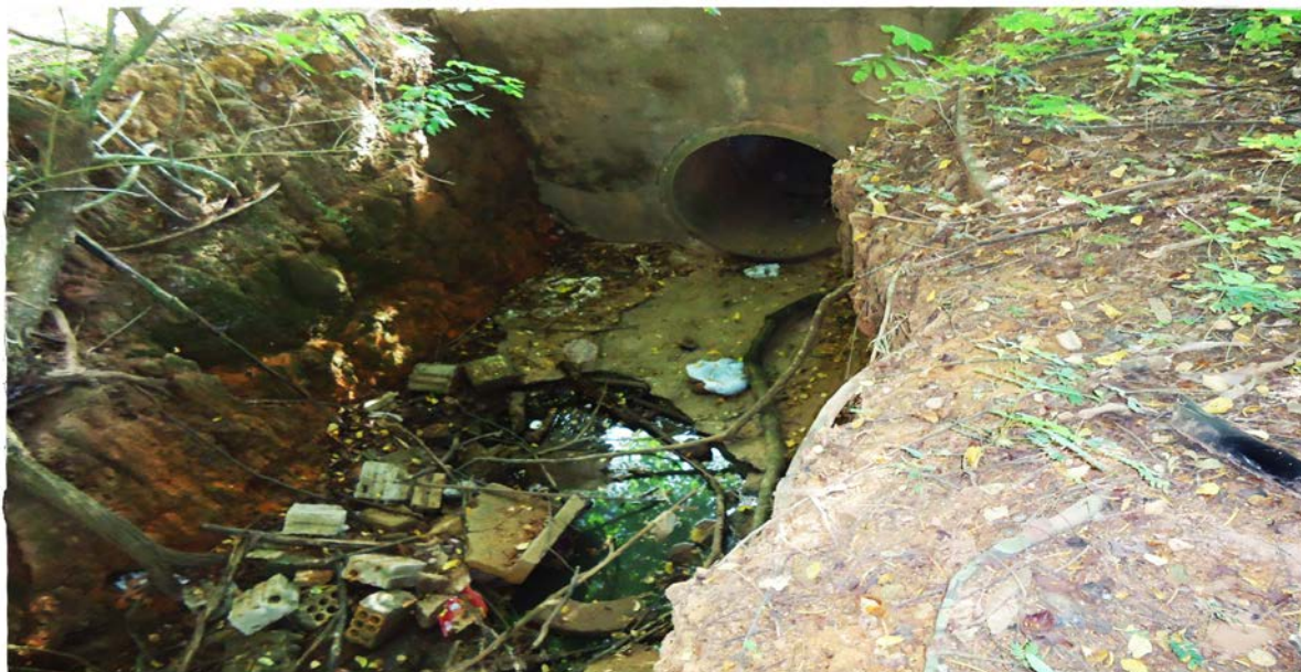
Figura 4. Despejo de esgoto urbano na nascente do Córrego Papai Noel.
