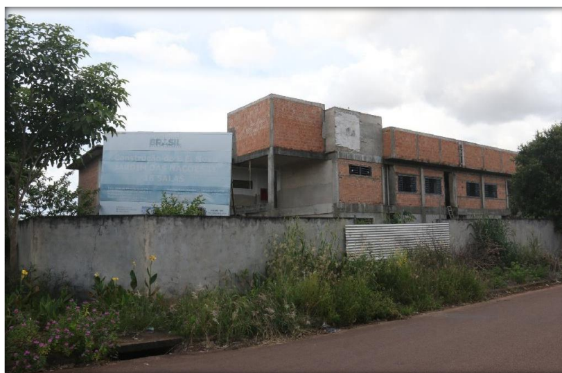
Figura 5 — Obra em escola pública estadual inacabada no município de Sinop — MT
