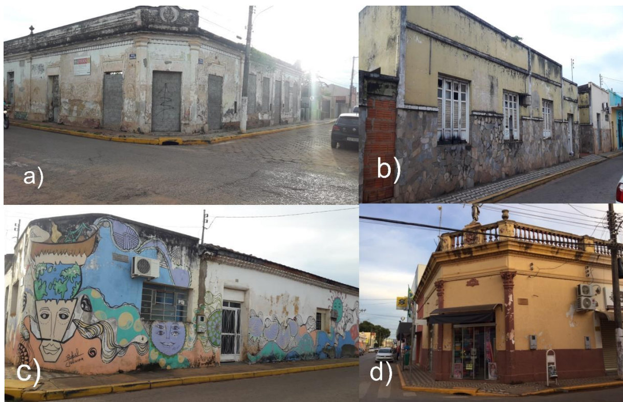
Figura 15 – a) e b) casas de patrimônio histórico da cidade de Cáceres abandonadas e que se encontram em deterioração; c) prédio residencial; d) prédio histórico e comercial Anjo da Ventura.
