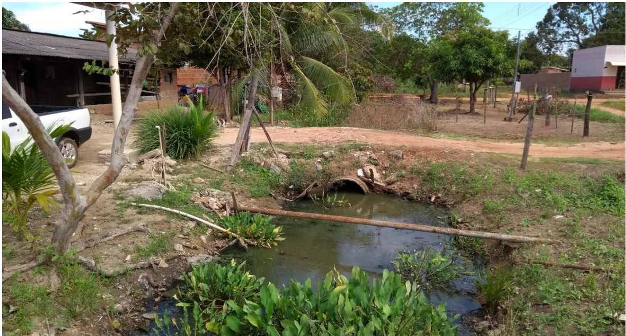
Figura 11 - Ponto 4 - Passagem do canal dentro dos lotes, bairro Cavahada III - Cáceres/Mato Grosso (2017)
