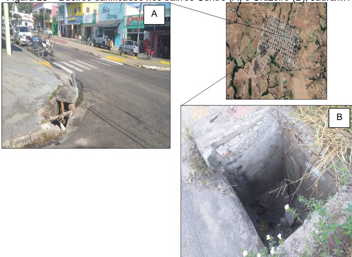
Figura 25 – Bueiros danificados nos bairros Centro (A) e Cruzeiro (B), Jauru/MT
