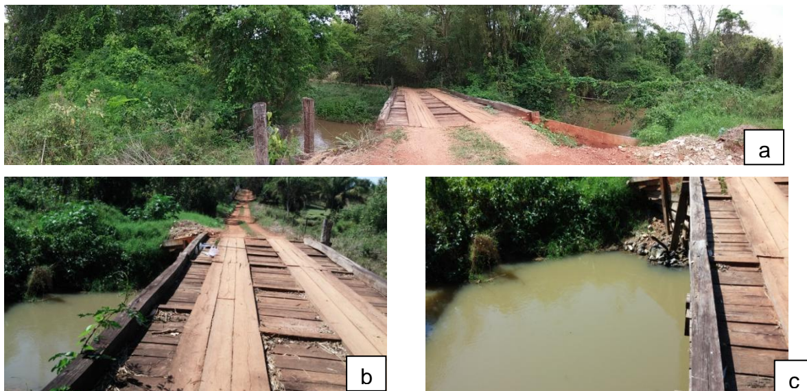
Figura 11 Trecho 4: (a) Foto panorâmica do Ponto 4, (b) e (c) Ponte após o curtume na estiagem.
