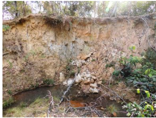
Córrego Fogaça 2 - CRFG2. (15°46'09.77"S e 52° 09'31.03"O). O mais impactado dos sítios de coleta. Faixa de mata ciliar de variando entre 5-15 metros. Assoreamento evidente, baixa profundidade em função do aporte de solo. Árvores caídas.
