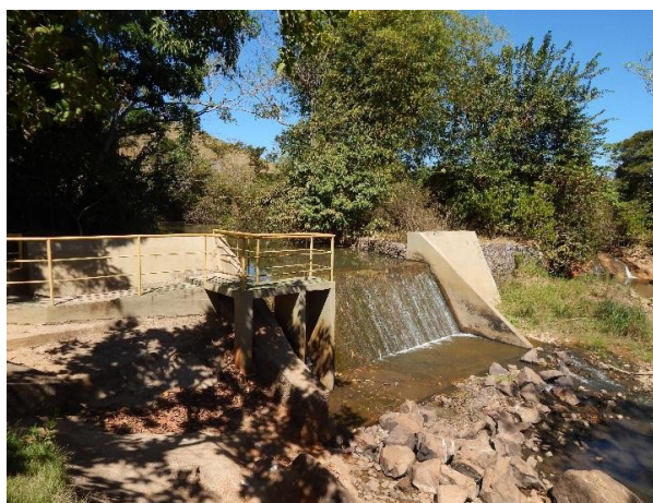
Figura 63 – Estação de captação de água no período de estiagem. Colíder, jul/2016.
