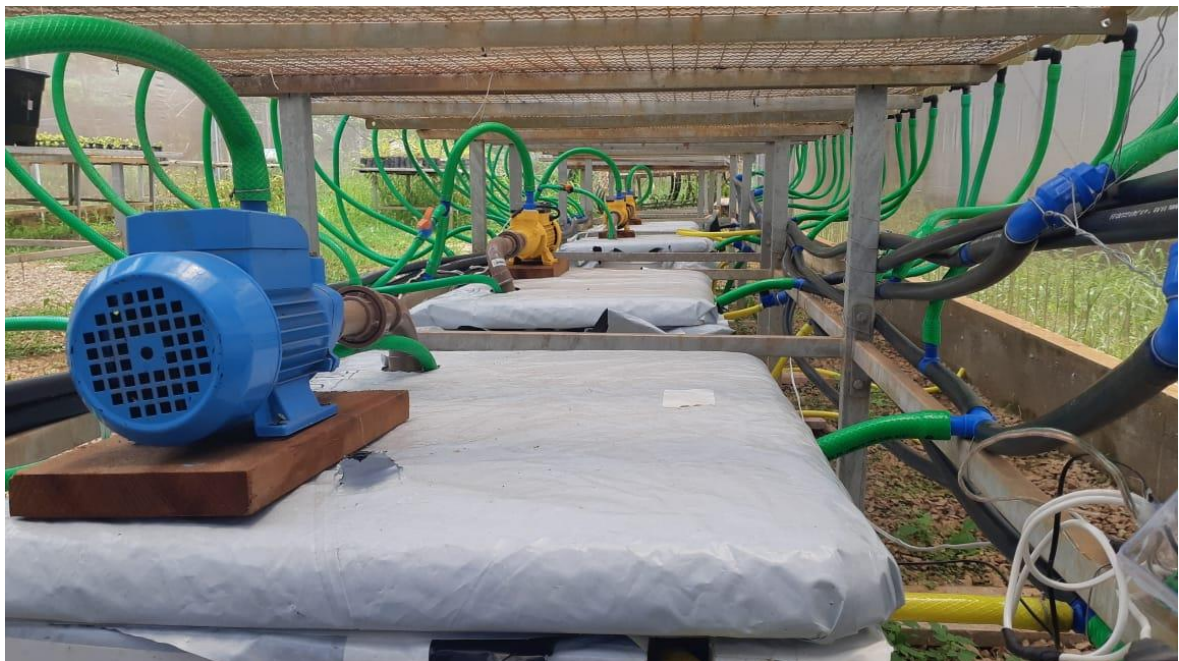
Figura 13 - Ilustra a disposição das bombas de circulação de solução, abaixo da estrutura.
